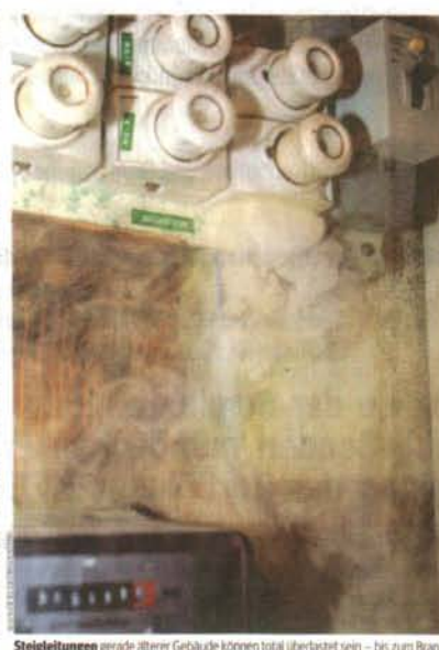
Stiegleitungen gerade älterer Gebäude können total überlastet sein – bis zum Brand
